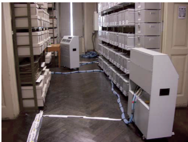
Abb. 11. Notfallprogramm zur Klimatisierung (Kühlen); Kältegeräte im Archiv; Temperatur 15°C bis 17°C, um den weiteren massenhaften Aufbau der Schadinsektenpopulation zu unterbinden.
