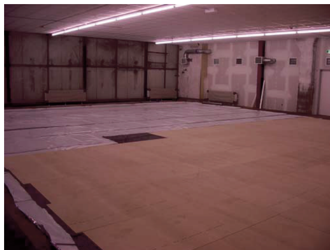
Abb. 12. Vorbereitung des Bodens in einer Lagerhalle, zur späteren Errichtung eines gasdichten Kunststoffzeltes zur Entwesung insektenbefallener Materialien.
