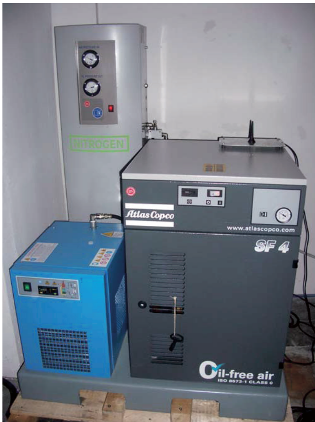
Abb. 15. Stickstoffherzeugung mit einer transportablen Stickstoff-Membrananlage mit Luftkompressor und Kältetrockner.
