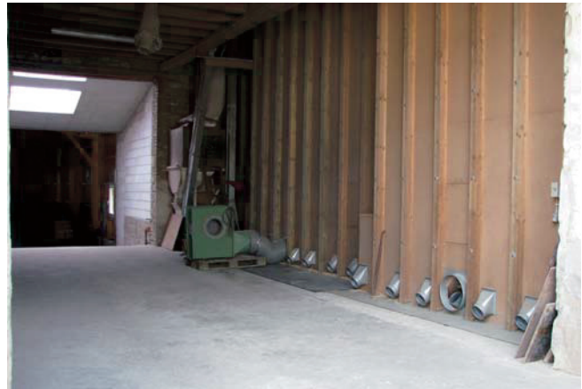
Abb. 1. In den letzten Jahren neu geschaffene, gut ausgestattete Lagermöglichkeiten; zum Teil geschickt ausgebaut Scheunen zur besseren Handhabung von Lagergetreide, zum Teil zu einfache Auskleidung der Lagerräume mit Spanplatten: Getreidekörner gelangen durch Ritzen und Spalten schnell unter oder hinter die Platten und bieten dann den Käfern geschützte Rückzugsräume.
